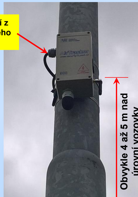
Instalace na sloup veřejného osvětlení
